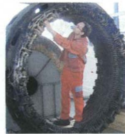
Dieser Drehstrom-Asynchron-Generator treibt normalerweise ein Wasserkraftwerk an. Bei der Krauter GmbH wird er neu gewickelt. Mechatronik-Industriemeister Norbert Fehrenbacher begutachtet das Teil.
